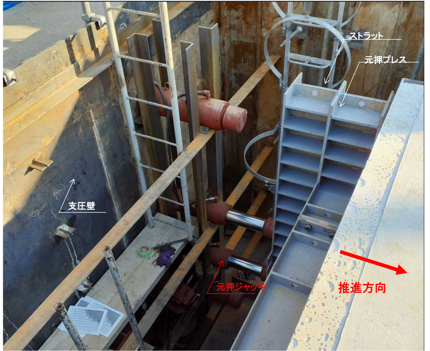
施工状況：発進立坑内に据付けた函体の元押し推進状況
